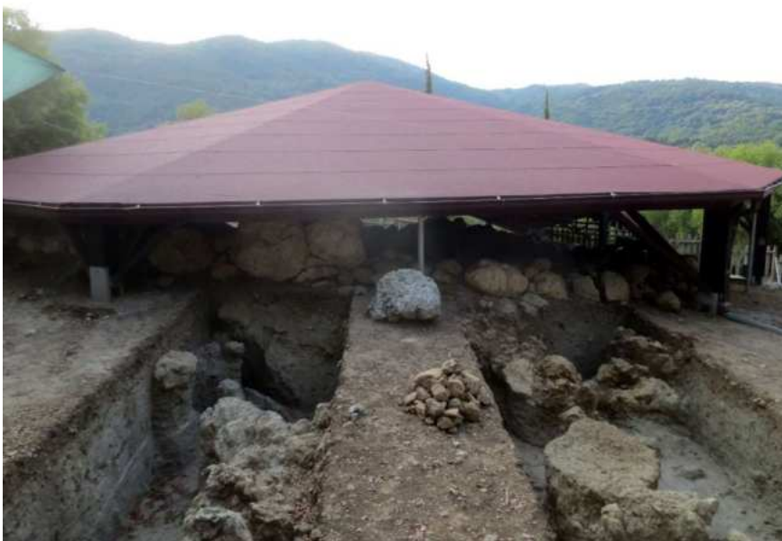
Εικόνα 2-3: Ξύλινο στέγαστρο προστασίας ταφικού μνημείου – λήψη από βορρά. Διακρίνονται πρόσφατα ολοκληρωμένες ανασκαφικές τομές
