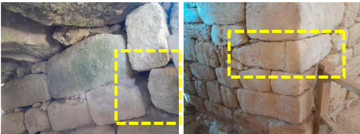
Εικόνα 2-9: Περιοχή πύλης. Αριστερά μετακινήσεις μεμονωμένων λιθόπλινθων – δεξιά ρηγματώσεις μεμονωμένων λιθόπλινθων.
