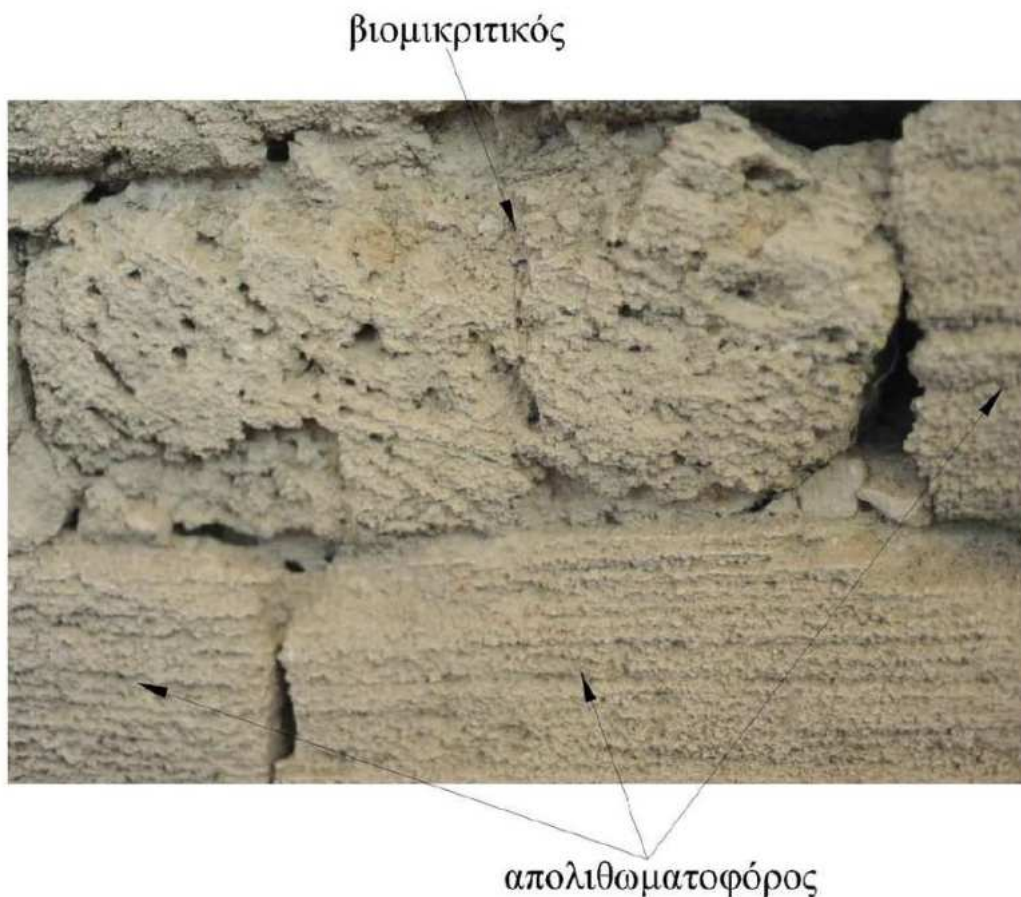
Εικόνα 4-3: Λιθόπλινθοι βιομικριτικού και απολιθωματοφόρου ασβεστόλιθου με έντονη διάβρωση (Άννα Αρβανιτάκη, Γεωτεχνική Μελέτη 2017)
